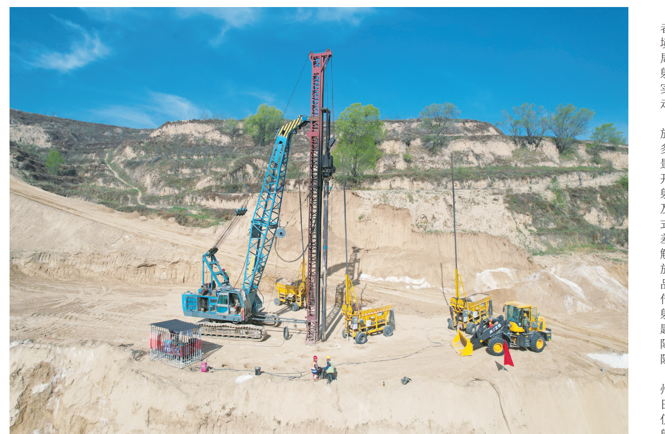
近日,由中国十九冶集团有限公司承建的兰永临高速公路项目LYL12合同段魏家坡互通特殊路基灰土挤密桩施工全面启动。施工采用灰土挤密桩工艺,依托打桩机成孔挤密、分层夯填灰土,有效消除黄土湿陷隐患,提升地基整体承载力,为后续路基填筑、桥梁施工创造有利条件,全力助推兰永临高速公路早日建成通车。 临夏融媒记者 张原厂 摄
