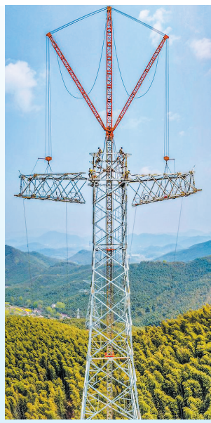
近日,在安徽省芜湖市繁昌区内,电力工人抢抓春季有利天气,奋战在甘肃—浙江±800千伏特高压直流输电工程施工建设一线,保障能源通道重点工程进度。甘肃—浙江±800千伏特高压直流输电工程是国家“十四五”电力发展规划重点工程,线路全长2370千米,工程贯通后每年可输送电能约360亿千瓦时。新华社发 郑贤烈 摄
