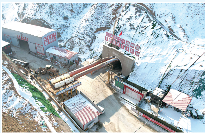
这是正在施工的兰合铁路考勒隧道2号斜井(12月17日摄,无人机照片)。
