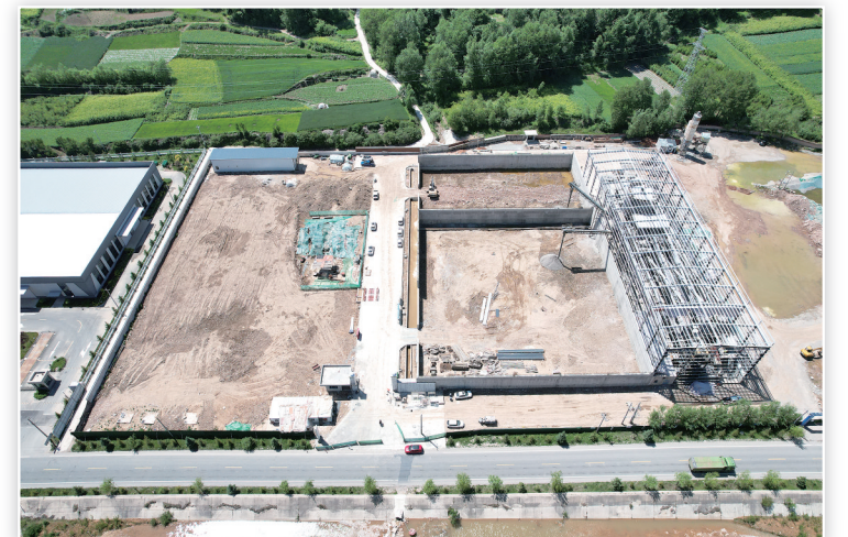
和政县宁河建筑废弃物回收再利用绿色产业园建设项目
