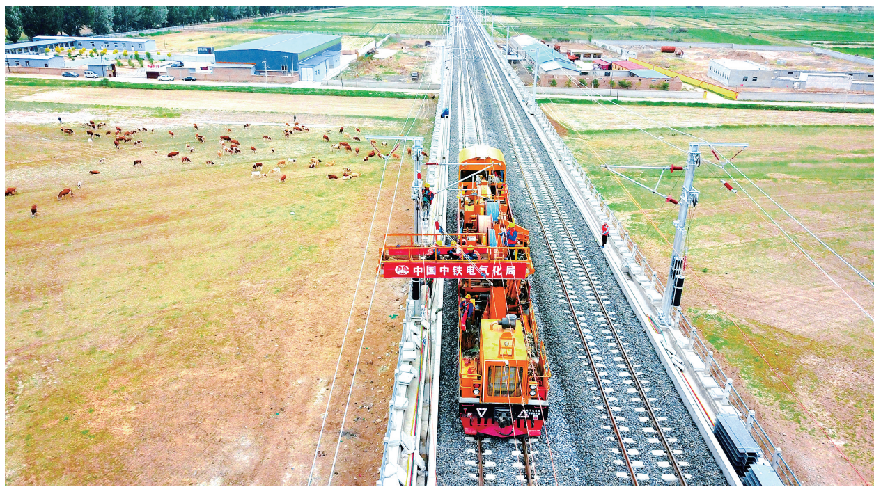
6月3日,工人在集大原高铁山阴南至应县西区间作业(无人机照片)。当日,由中铁电气化局参建的集宁经大同至原平高速铁路(集大原高铁)首批接触线成功架设,标志着集大原高速铁路四电工程施工进入冲刺阶段。集大原高铁是我国“八纵八横”高速铁路网呼南通道的重要组成部分,预计2024年底具备通车条件。新华社发 王世棋 摄
