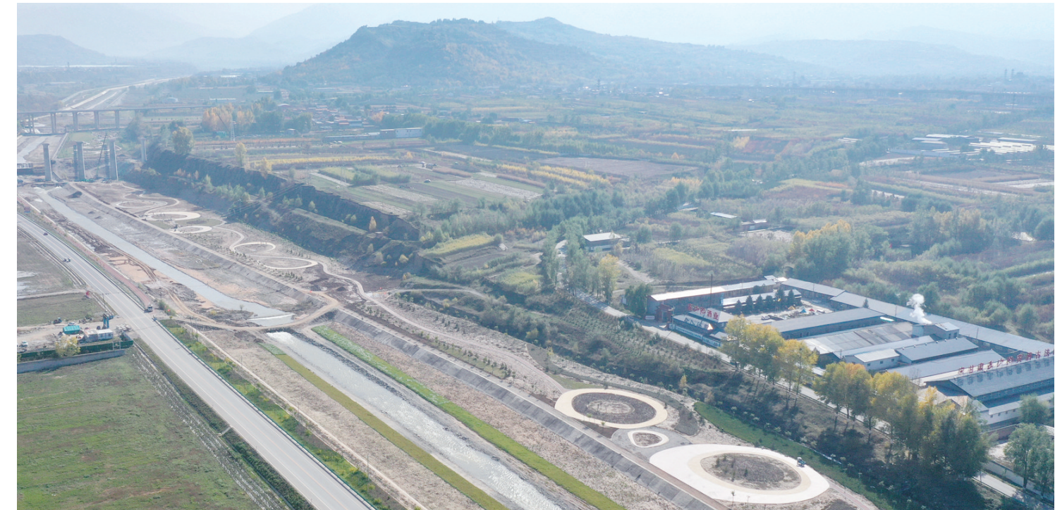
临夏县槐树关河生态综合治理工程项目总投资1.1亿元,建成后可为周边群众提供宜居休闲的良好生活环境。目前,该项目已完成总工程量的90%。
