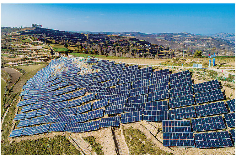
景古村光伏发电
