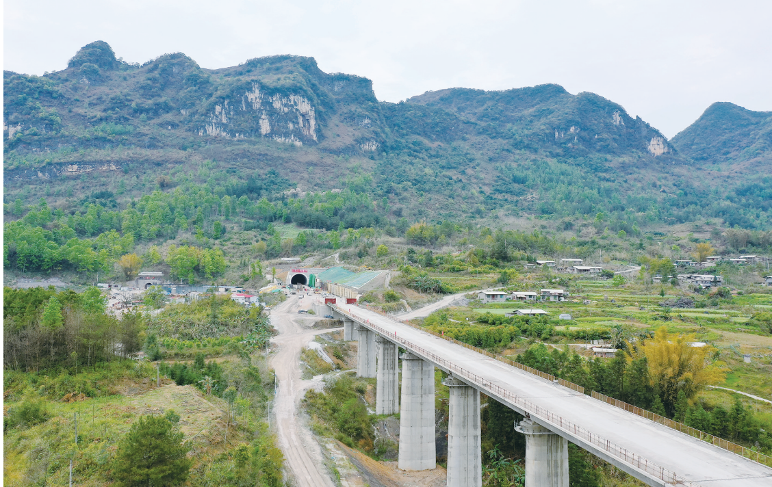
▲这是3月24日拍摄的九方大山一号隧道出口(无人机照片)。当日,由中铁十八局承建的贵南高铁最长隧道九方大山一号隧道顺利贯通。据了解,该隧道全长17012米,施工难度大,是全线重要控制性工程,此次贯通为贵南高铁全线贯通奠定基础。贵南高铁设计时速350公里,是我国“八纵八横”高速铁路主通道包头至海口通道的重要组成部分。新华社记者 刘续 摄
