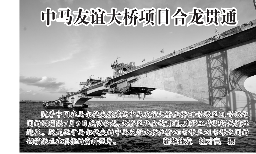
中马友谊大桥项目合龙贯通 随着中国在马尔代夫承建的中马友谊大桥主桥20号墩至21号墩之间的钢箱梁7月9日成功合龙,大桥至此全线贯通,建设取得关键性进展。这是位于马尔代夫的中马友谊大桥主桥20号墩至21号墩之间的钢箱梁在顶推的资料照片。
